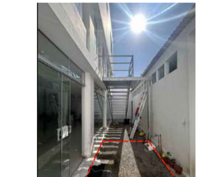
Se implementa un vaciado el piso para garantizar la accesibilidad a la persona con discapacidad.
