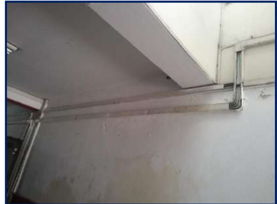
Instalaciones eléctricas y de data adosadas en mal estado.
