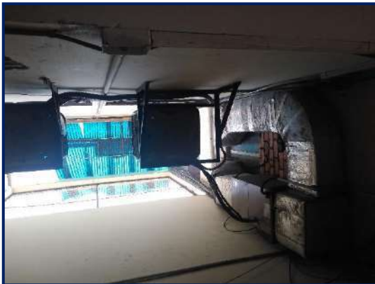
Traga luz central cobertura deteriorada, filtración de agua pluvial.
