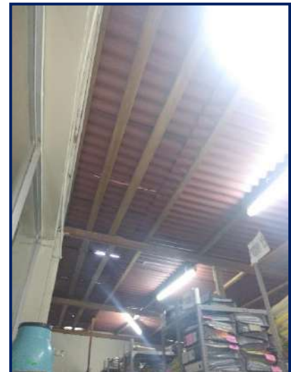
Patio exterior con cobertura liviana tipo Eternit con estructura de madera en mal estado.
