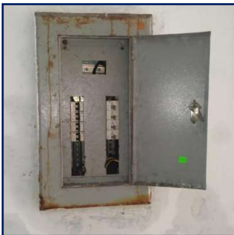
Vista del tablero de distribución corroído por la humedad, inadecuados circuitos para funcionamiento de oficinas.
