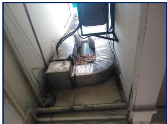
Instalaciones eléctricas y sanitarias expuestas, cables sin canaletas, mangas de ventilación del primer y segundo piso.
