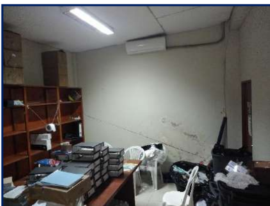
Falso cielo raso en mal estado, pared con eflorescencia de salitre.
