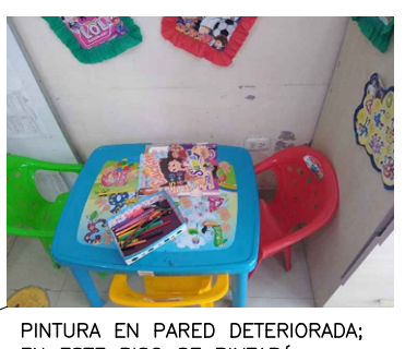
PINTURA EN PARED DETERIORADA, EN ESTE PISO SE PINTARA PAREDES, COLUMNAS, VIGAS Y CIELORASO.
