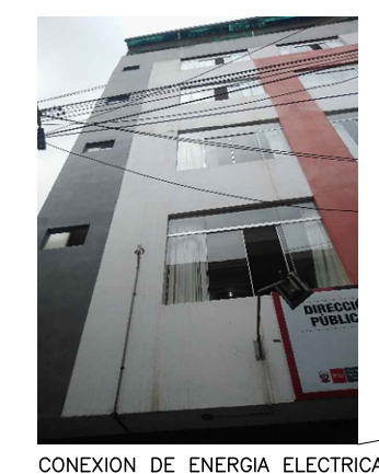
CONEXION DE ENERGIA ELECTRICA QUE VIENE DEL MEDIDOR, (REUBICAR), PINTURA EN PARED DETERIORADA (PINTAR).
