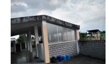
AZOTEA: TERRAZA PISO DE CERAMICO EN ESTADO REGULAR POR FALTA DE MANTENIMIENTO Y/O LIMPIEZA - EXPUESTO A LA INTERPERIE.
