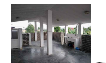
AZOTEA: PISO ENCHAPADO CON CERAMICA EN ESTADO REGULAR FALTA DE MANTENIMIENTO Y/O LIMPIEZA. PAREDES: TIPO CARAVISTA AL NATURAL. LUMINARIAS EN MAL ESTADO.
