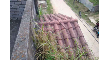
COBERTURA DE BALCON: LOSA DE CONCRETO. PROTECCION CONEJA DE ETERNIT. FALTA MANTENIMIENTO, CRECIMIENTO DE MALEZA.
