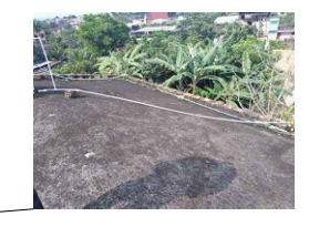
TECHO DE AZOTEA: INSTALACION DE AGUA POTABLE. TUBERIAS EXPUESTAS - ALIMENTADOR AL TANQUE ELEVADO Y DEL TANQUE ELEVADO ALIMENTA A LA EDIFICACION
