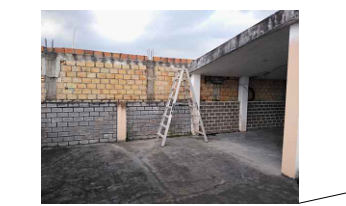
AZOTEA: TERRAZA PISO DE CERAMICO EN ESTADO REGULAR POR FALTA DE MANTENIMIENTO Y/O LIMPIEZA - EXPUESTO A LA INTERPERIE.
