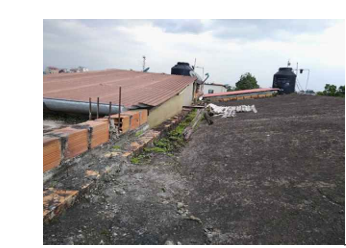
AZOTEA: TECHO ALIGERADO FALTA MANTENIMIENTO, EMPOZAMIENTO DE AGUAS PLUVIALES Y FILTRACION HACIA EL PISO DE LA AZOTEA.
