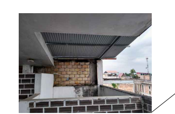
AZOTEA: POZO DE LUZ TECHADO CON COBERTURA LAMINA CALAMINA ONDULADA DE ZINC PAREDES: PINTURA DETERIORADA POR HUMEDAD PLUVIAL.
