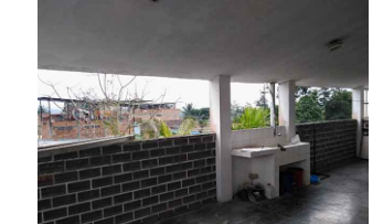
AZOTEA: PARAPETO ALTURA 1.23 m. EL INTERIOR EXPUESTO AL INGRESO DE AGUAS PLUVIALES.
