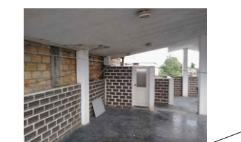
AZOTEA: CIELO RASO EXISTE FILTRACION DE HUMEDAD FALTA IMPERMEABILIZACION
